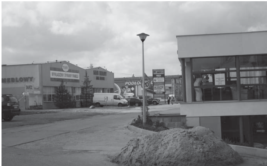
Budowa układu dróg wewnętrznych na terenie byłej „fabryki domów” odciąża ulicę Jagiellońską.
