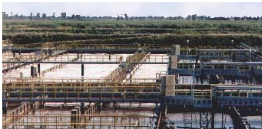
Oczyszczalnia ścieków przy ul. Czatkowskiej 8. Widok ogólny bloku oczyszczania biologicznego. Fotografia z 2007 roku.
